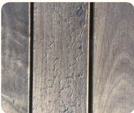
Lames dégradées par un nettoyeur haute pression (>100 bar) et présentant une surface fibreuse.
