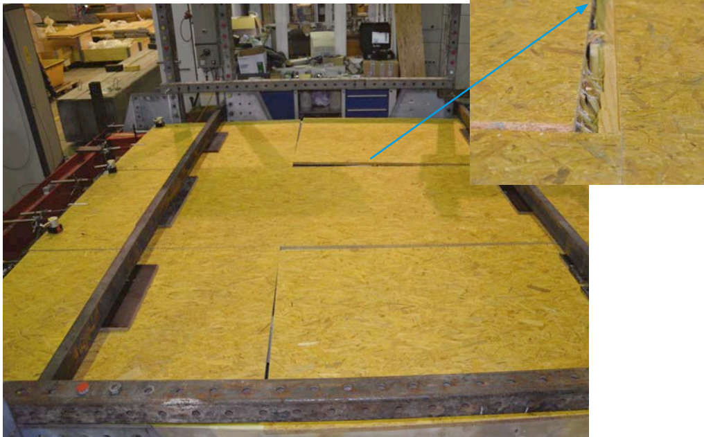
11 | Verglijding van de op een balkenvloer vernagelde OSB-platen met rechte randen door afschuiving van de nagels na een cyclische belastingsproef.
